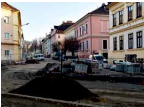
Hlavní část stavebních prací nyní probíhá na křižovatce ulic Palachova a Křižíkova.
