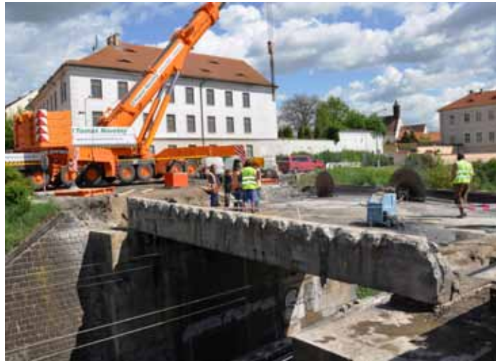
Práce na demolici starého mostu přes železniční trať byly komplikované, a to i s ohledem na provoz vedoucí po trati. Probíhaly často v noci.
